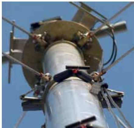
Seilabspannung am Mast
